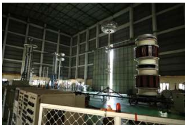
ईएचवी केबिल परीक्षण बे
